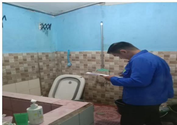
Kondisi Tempat Jamban
