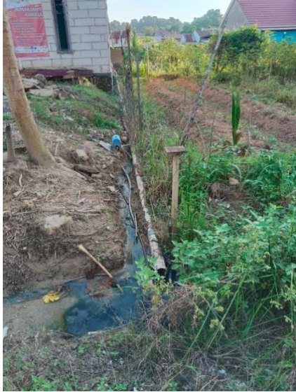
Air limbah yang mengotori permukaan tanah
