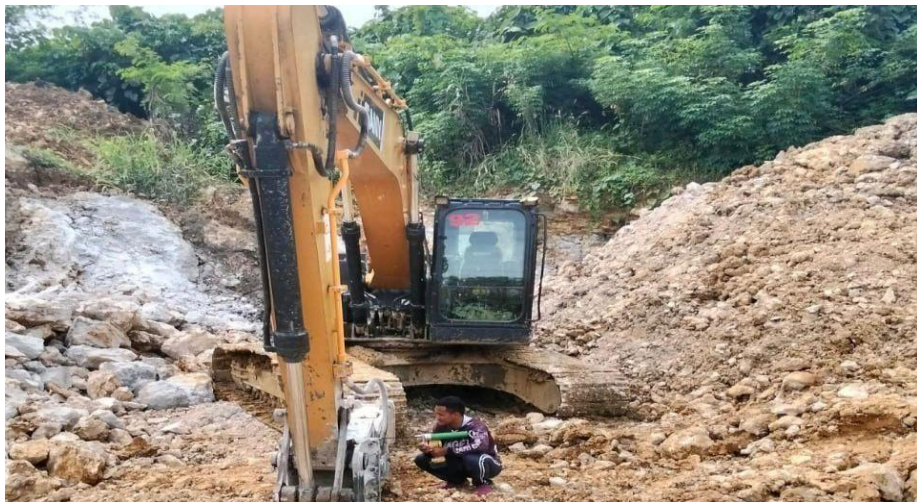
Gambar 4.3 Pekerja Tidak Menggunakan Alat Pelindung Diri (APD)
