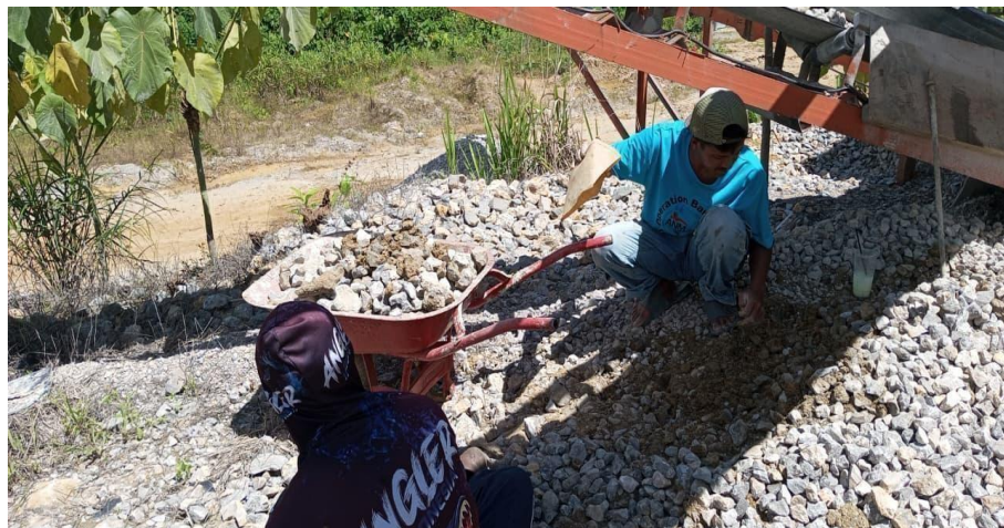
Gambar 4.4 Pekerja Tidak Menggunakan Alat Pelindung Diri (APD)
